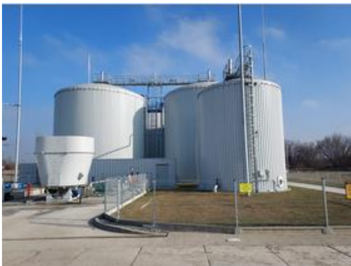
Rysunek 10. Biogazownia rolnicza przy zakładzie przetwórstwa drobiu
